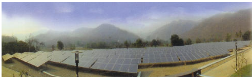
โรงไฟฟ้าเซลล์แสงอาทิตย์ผาบ่อง ขนาดกำลังผลิตติดตั้งสูงสุด 500 กิโลวัตต์ ที่ ต.ผาบ่อง อ.เมืง
