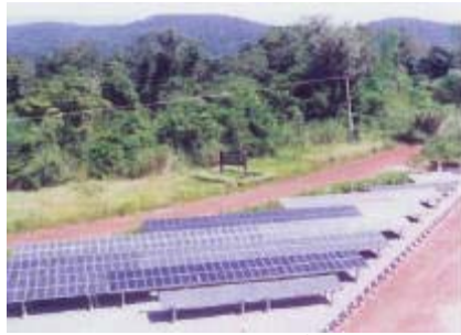
สถานีพลังงานแสงอาทิตย์คลองช่องกล้า อ.วัฒนานคร จ.สระแก้ว
