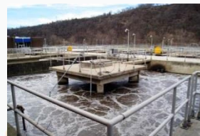
การบำบัดน้ำเสีย
