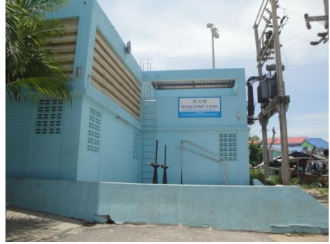
สถานีสูบน้ำเสียที่ 3 (PS3)
