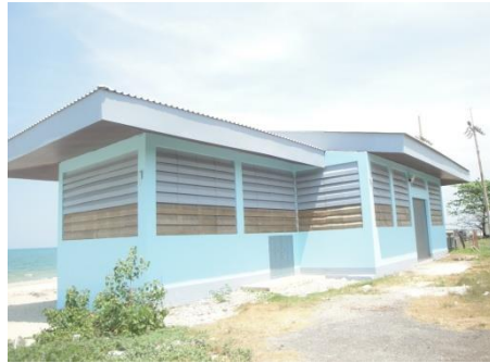
สถานีสูบน้ำเสียที่ 4 (PS4)
