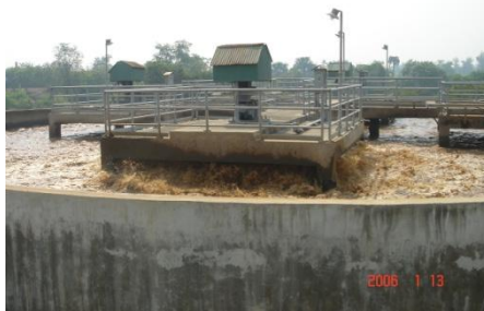
รูปที่ 3 ถังเติมอากาศระบบแอกติเวทเต็ดสลัดจ์
