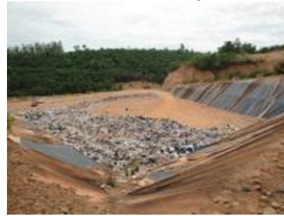
ระบบกำจัดขยะมูลฝอยแบบถูกหลักสุขาภิบาล เทศบาลเมืองบ้านพรุ
